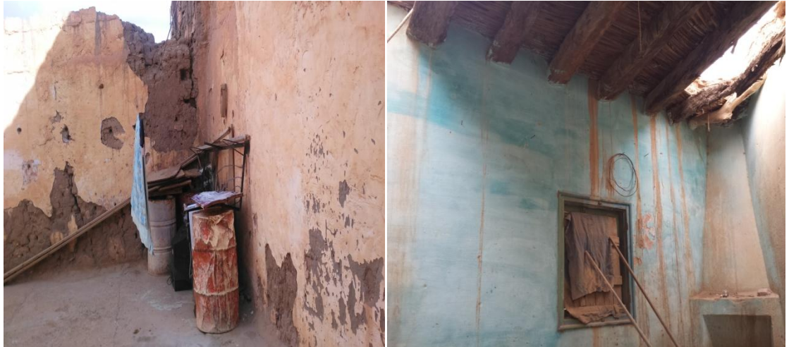
صورة 2. تآكل تلبس الجدران بسبب مياه الأمطار. صورة 3. انحيار الأسقف بسبب تضرر العناصر الخشبية.
