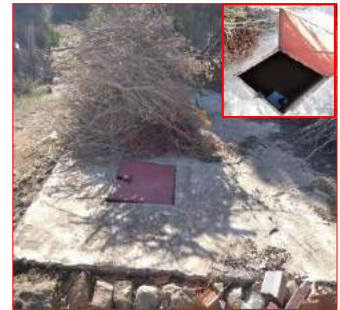
صورة 5: مطفية لتجميع المياه
